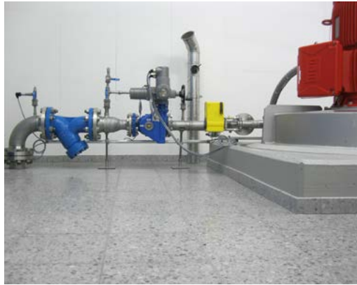
Anschluss auf Turbine mit Schmutzfänger und Kugelhahn Erhard PN 64
