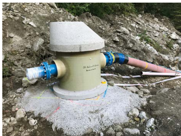
Revisionsfertigschacht Fabr. Enke PN 40, total acht Stück
