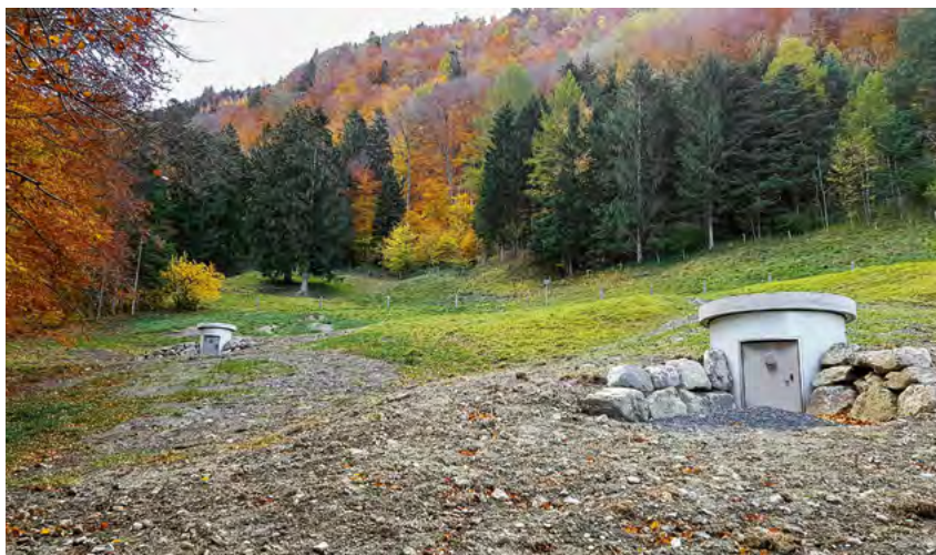
Zwei der insgesamt sechs neuen Brunnenstuben, DN 1800 und DN 2200, in die Erde und Umgebung eingebettet
