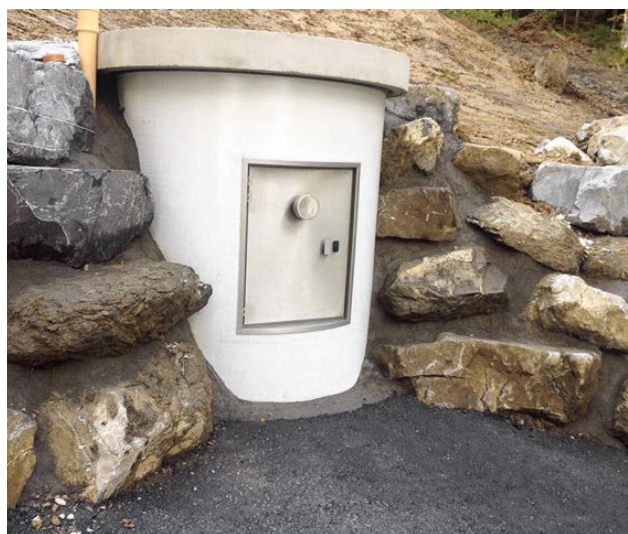
Brunnenstube Aquaniro mit Fronteinstieg
