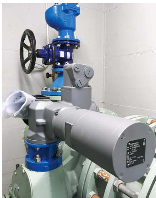
Auf die bestehende Absperrklappe wurde ein AUMA E-Antrieb mittels Halslagerstück gesetzt. Der Flanschabgang im Hintergrund erhielt zusätzlich ein neues FFR/EWS-Reduzierstück mit Flansch-Schieber und Twin Air Be- und Entlüfter.
