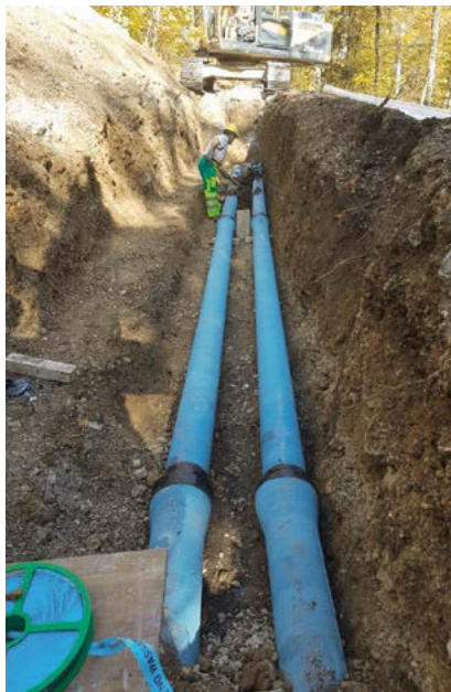
Verbindung zwischen dem alten und neuen Reservoir, DN 200, Typ FZM/BLS. Accouplement entre l'ancien et le nouveau réservoir, DN 200, type FZM/BLS.
