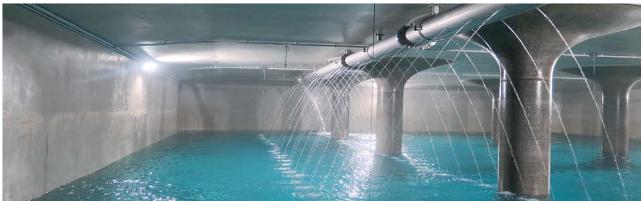
Berieselung der Wasseroberfläche im Reservoir
