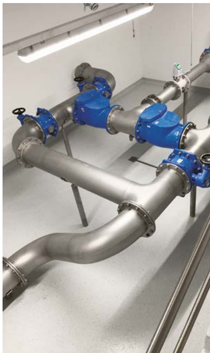
Erhard-Armaturen für das neue Reservoir Oberstrick
