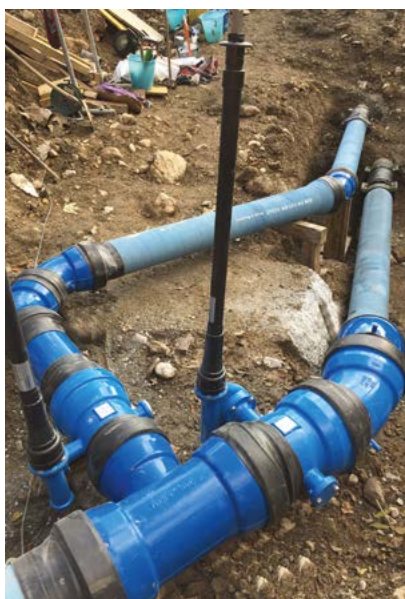
Zusammenschluss mit Erhard-Roco-BLS-Steckmuffenklappe von und mit dem alten Leitungsnetz
