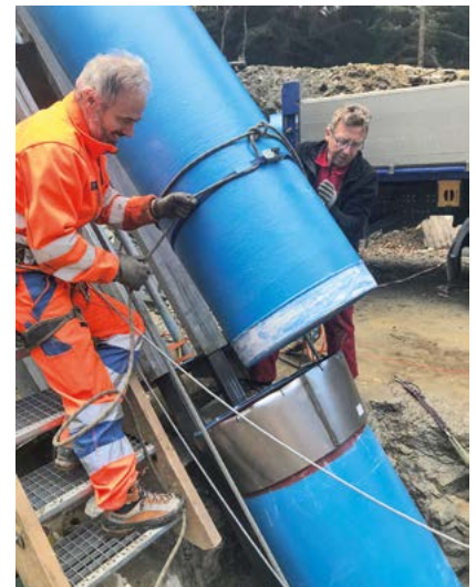
Erstellen der Rohrverbindung – man beachte das starke Gefälle. Einmal mehr bewährte sich hier die robuste, aber dennoch flexible Muffenverbindung BLS/TKF. Montagezeit trotz schwieriger Einbaulage max. 10 Minuten pro Muffe!
